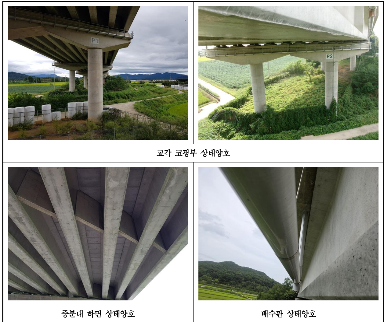
【사진 4.3.54】 교량의 공중이용시설 10대 위험요소 손상현황
